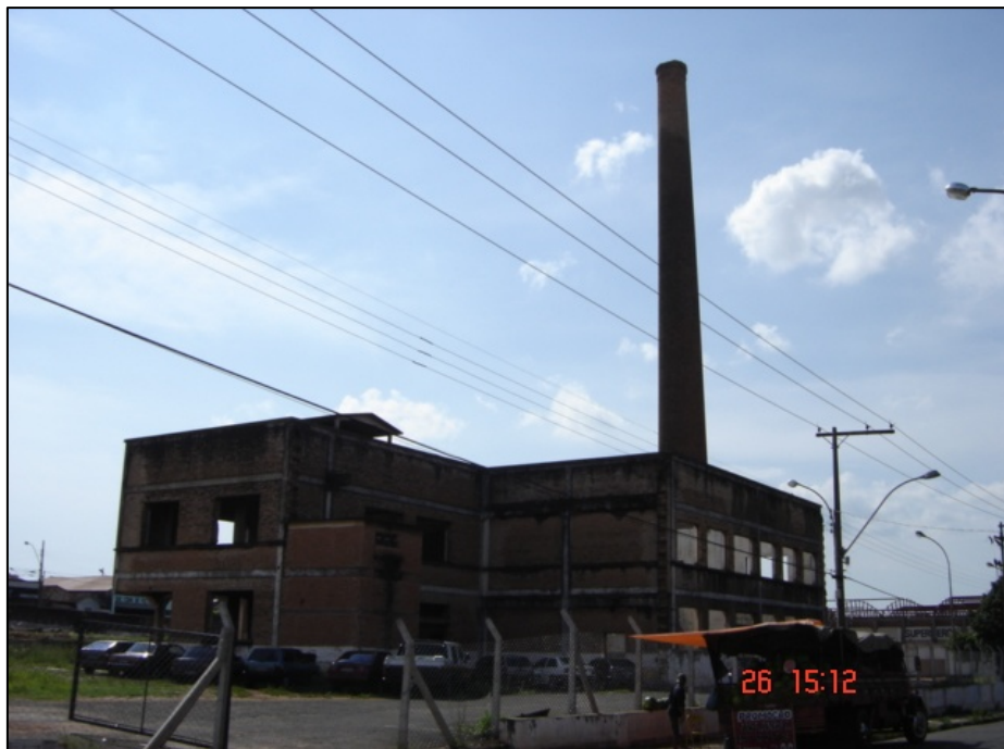
Figura 2: Vista geral da casa das caldeiras e chaminé, antes da reforma, em 2005, e nessa fotografia é possível observar o antigo uso do imóvel, um estacionamento de veículos, sem nenhuma estrutura, em estado de ruínas e abandonado. Autor: Rodrigo Modesto Nascimento, 2005.
